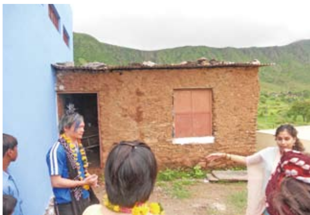
昔の学校。窓も電気もないので暗くて雨漏りもする
