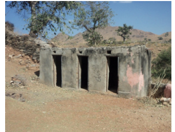
扉・照明が無いトイレ（インド）
